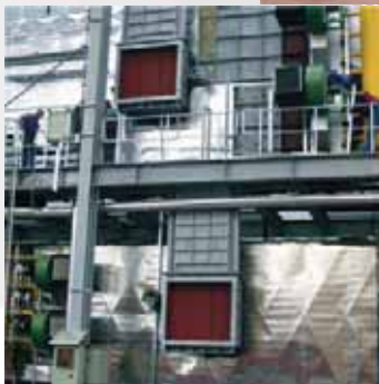
Absperrschieber, Klappe und Gasflächenbrenner
