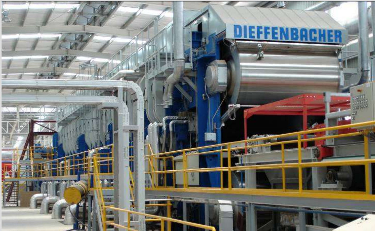
Anlage zur Herstellung von Holzwerkstoffplatten
